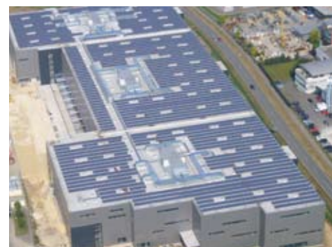
1MW-Anlage, Aufdachanlage, Holy-AG (Deutschland) 1MW Installation (Germany)
